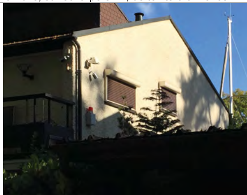
Les coffrets d'enroulement en saillie de façade sont interdits (photo).
