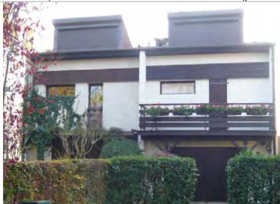
Interdiction de peindre ou de recouvrir les bandeaux d'étage en béton, la restitution du béton apparent est à restituer dans le cas où il aurait été peint ou recouvert de frissette
