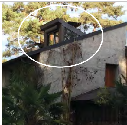
Les joues de lucarnes vitrées sont Interdites
